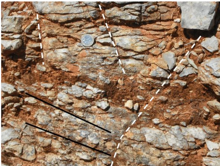
Figura 7.1. Alteração do calcário da Formação de Escarpão. As fraturas representadas com linhas brancas tracejadas e os planos de camada representados com linhas pretas contínuas, facilitam a penetração da água. Note que os planos de camada estão quase completamente obliterados devido à alteração. Desta, resultam fragmentos de calcário e argila de cor vermelha (terra rossa). Na alteração deste afloramento, concorreram ambas as formas de meteorização: química (dissolução) e física (fraturação).
